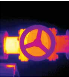
Yalıtımsız vananın termal kamera görüntüsü
